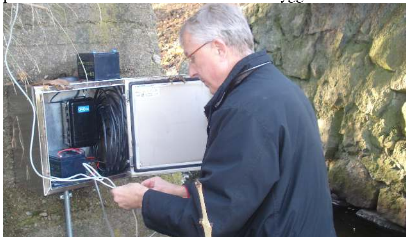
Installation av mätutrustning för att mäta vattenföring i Norrån mellan Ågestasjön och Magelungen. Foto Iréne Lundberg.
